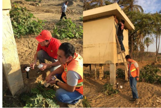
Fotos 15 y 16. Instalación de sensores electromecánicos de nivel como SAT para los barrios Miraflores y Lalamor
